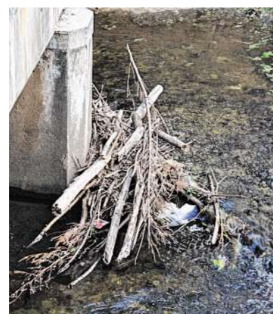
Der Müll im Bach bildet Barrieren, die das Wasser stauen und zu Überschwemmungen führen können.
